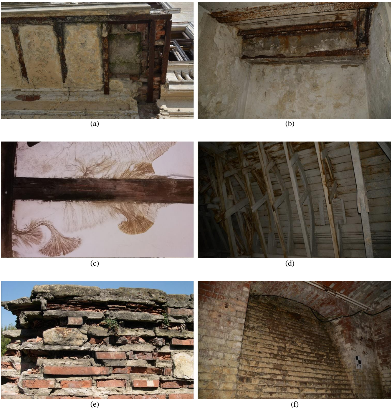
Fig. B.1. Exemple de degradare ale materialelor de construcție: (a) și (b) elemente metalice corodate; (c) și (d) atac biologic asupra lemnului; (e) zidărie afectată de îngheț/dezghet; (f) zidărie afectată de migrația sărurilor.
