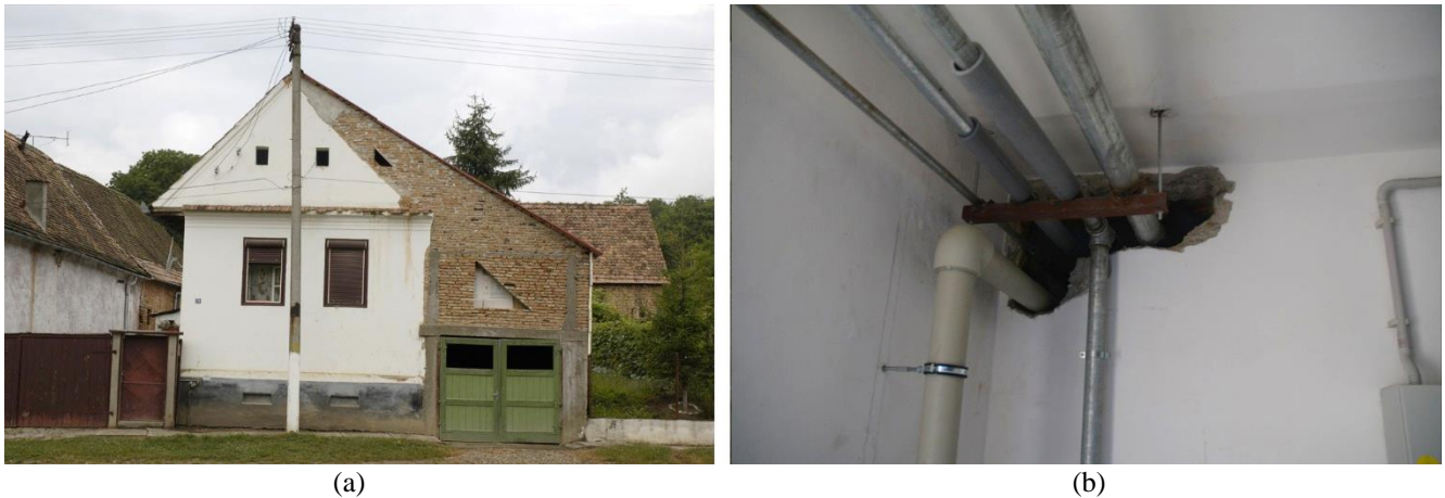
Fig. B.5. Afectarea structurilor în timpul exploatării: (a) extinderi ale construcției inițiale; (a) spargerea unor goluri pentru montarea instalațiilor.
