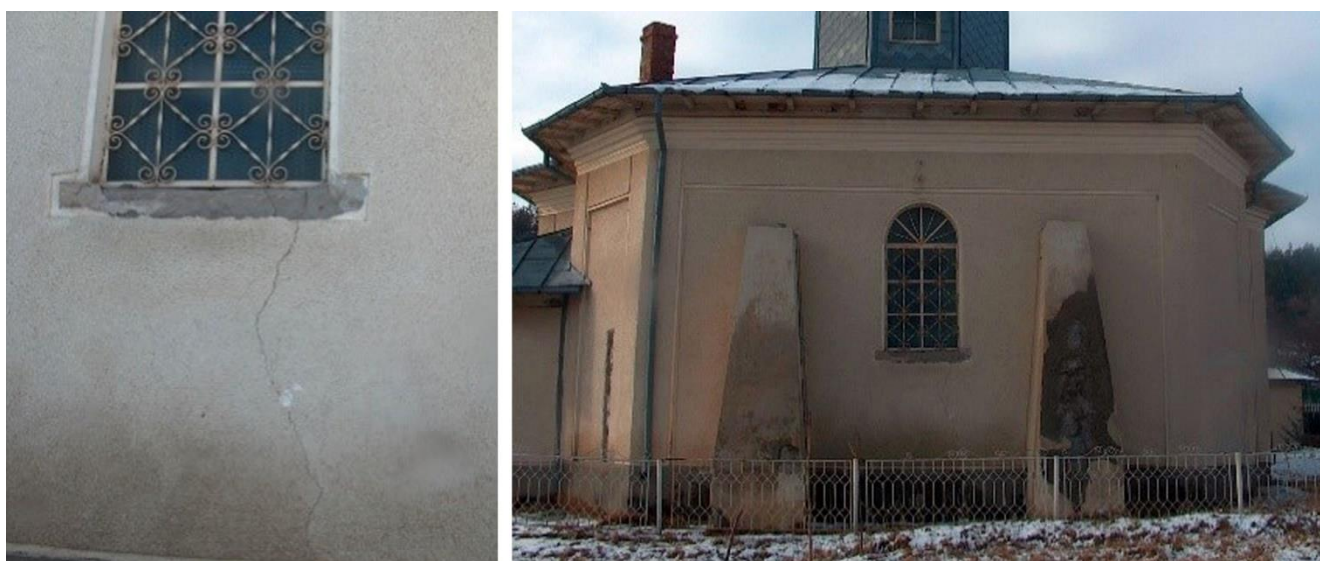
(a) (b) Fig. B.4. Fațadă cu igrasie și fisuri provocate de umezirea terenului de fundare: (a) fisură vizibilă în zona de colț a golului de fereastră a altarului; (b) contraforții care flanchează absida altarului sunt afectate de apa capilară.
