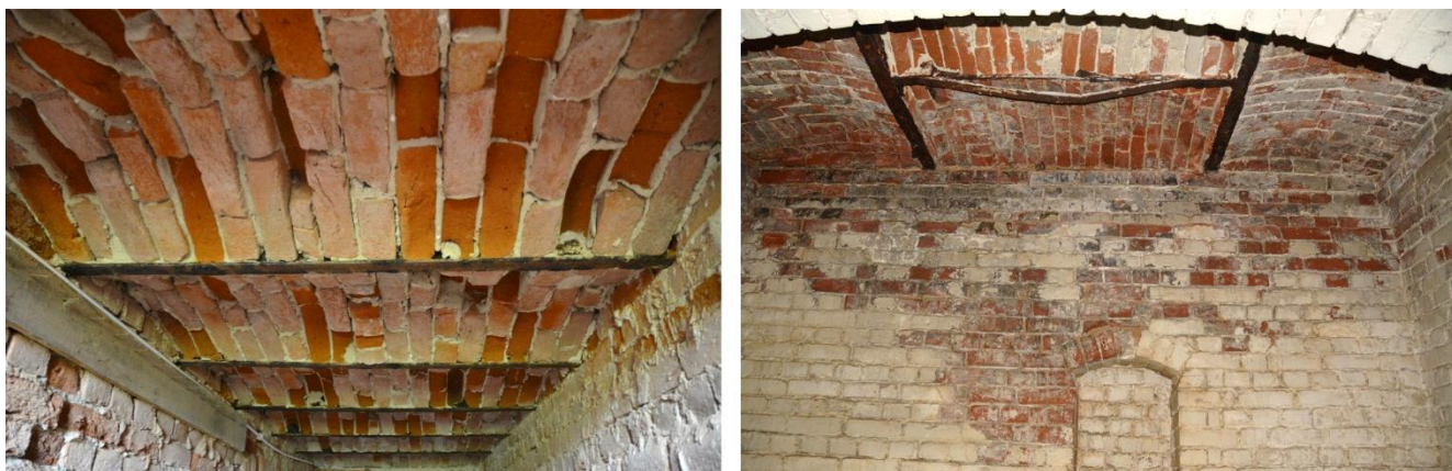
Fig. B.10. Avarierea planșeelor cu grinzi metalice și bolțișoare de cărămidă.
